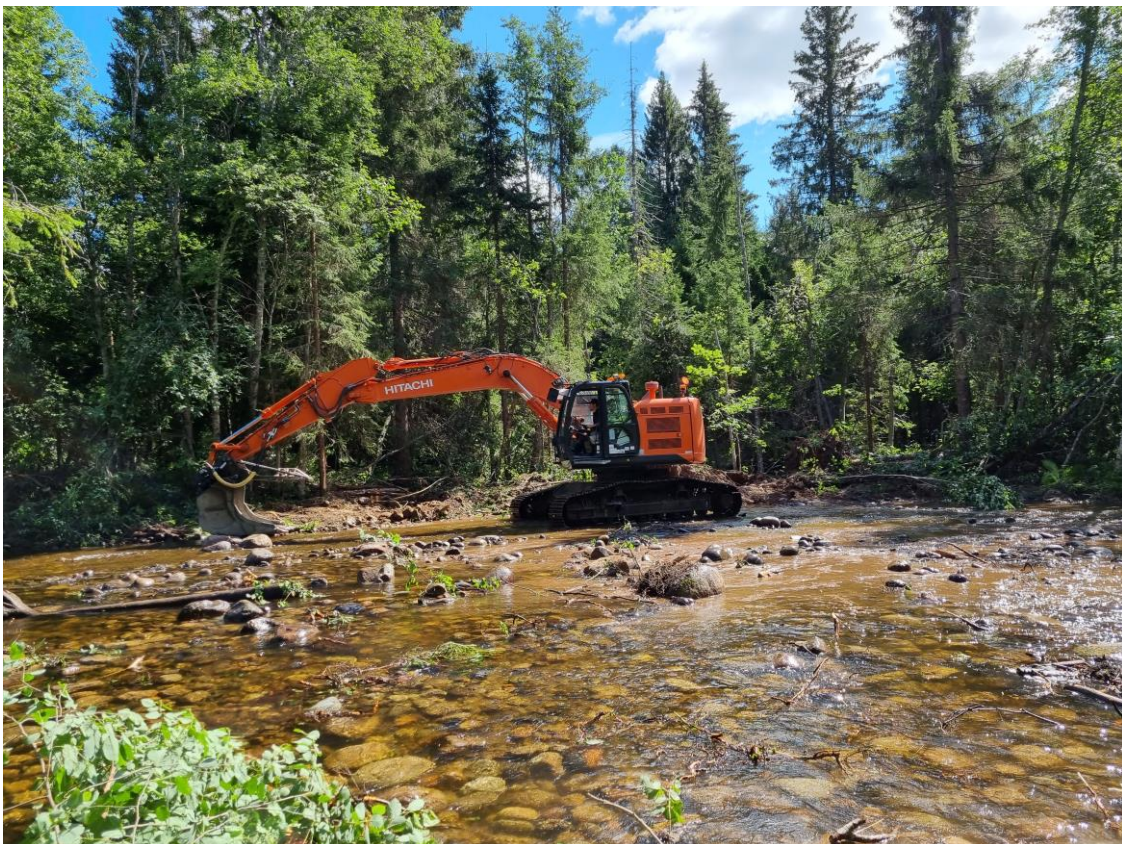
Figur 25. Arbetsbild Objekt 4. Här syns slutet av arbetet att återföra materialet från rensvallen 1773 till vattnet. Denna återskapade flacka strandkant breddade ån och möjliggör att vattendraget kan svämma in mot svämplanet.
