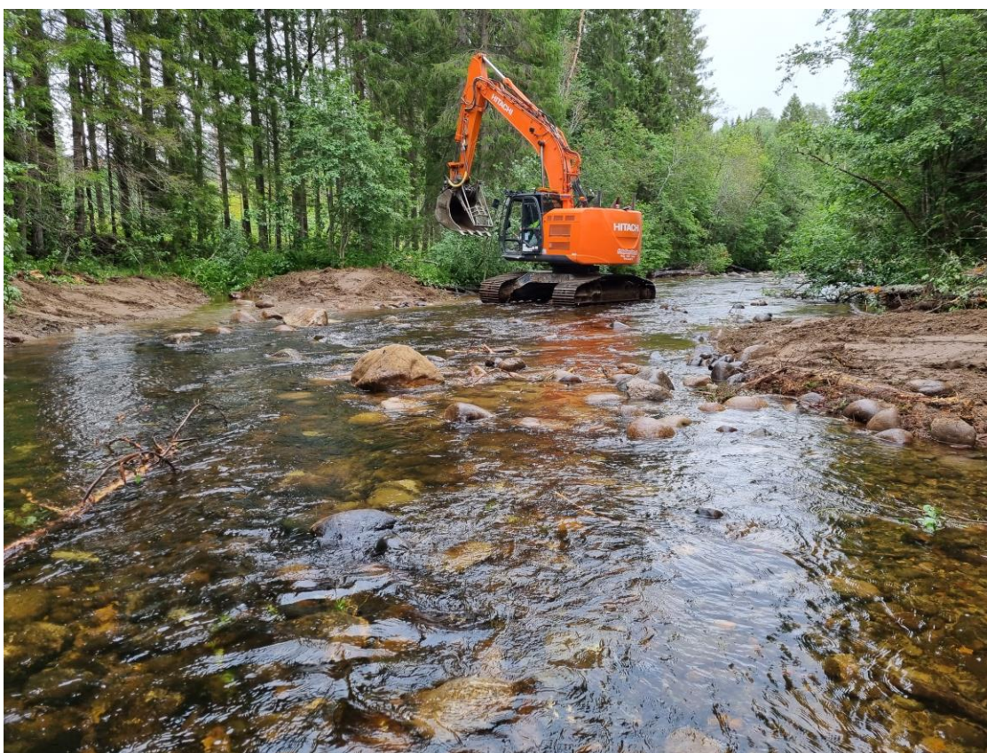
Figur 13. Arbetsbild Objekt 2. Återöppnande av sidofåra 542 nedströmsvy RL. Stockkistorna plockades bort och den döda veden återfördes till vattnet.
