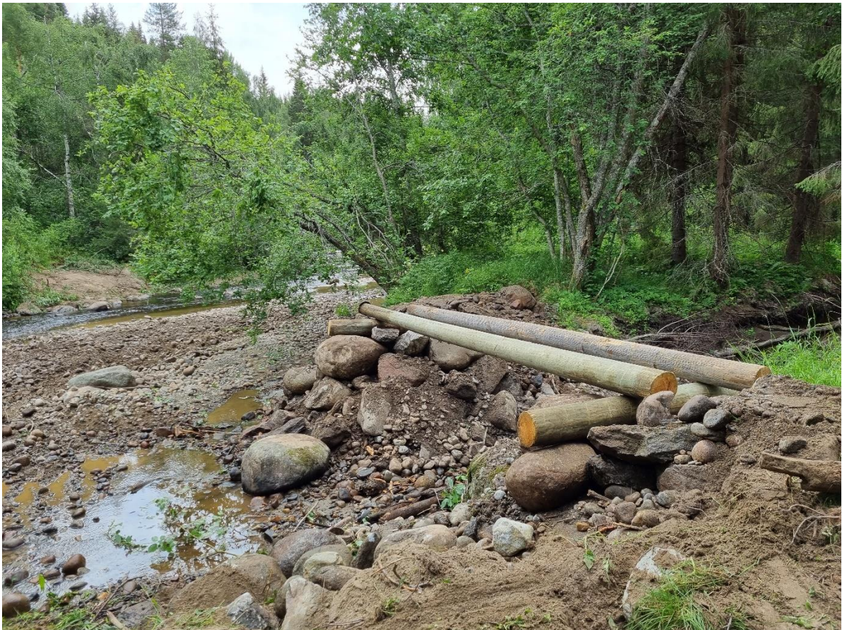
Bild 1. Förstärkt inlopp till sidofåra vid Slussen. Objekt 1.
